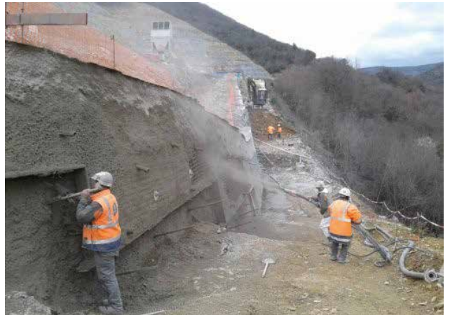
Réalisation du mur de soutènement de la montée des Combes (photo DIRCE mai 2020)
